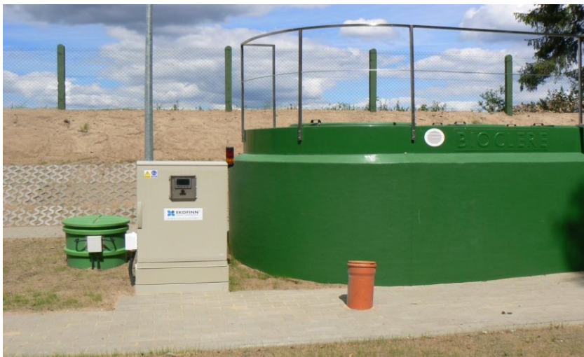
Oczyszczalnia ścieków w Niemieńsku
