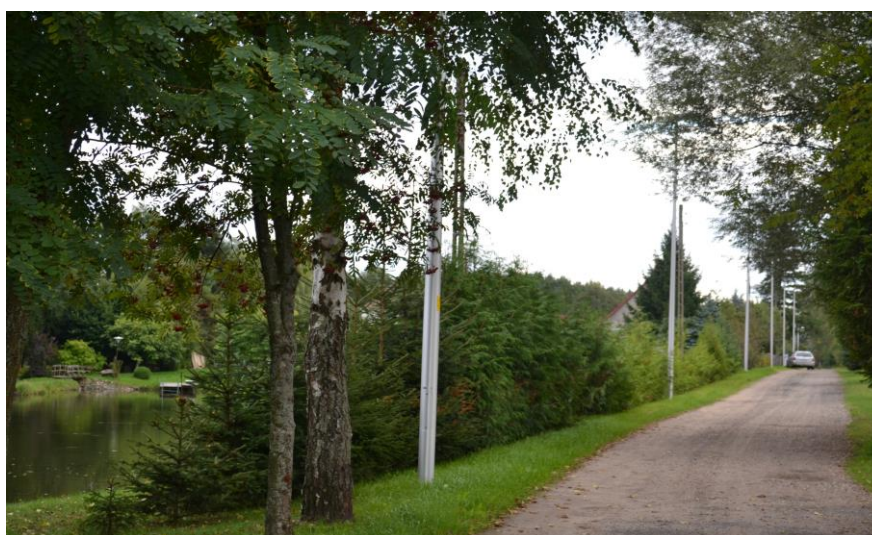
Oświetlenie na ul. Młyńskiej w Dominikowie
