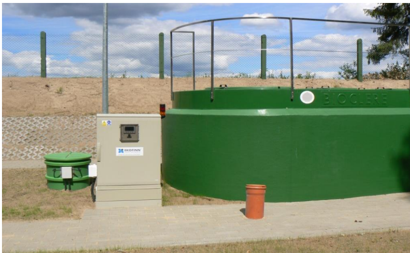
Oczyszczalnia ścieków w Niemińsku
